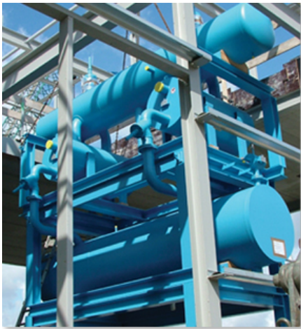
Компактный каскадный холодильный модуль. Под аммиачным сепаратором находятся два каскадных кожухо-пластинчатых теплообменника NH 3 -CO 2 и сосуд с CO 2 .
